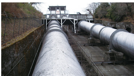
発電所の水圧鉄管
